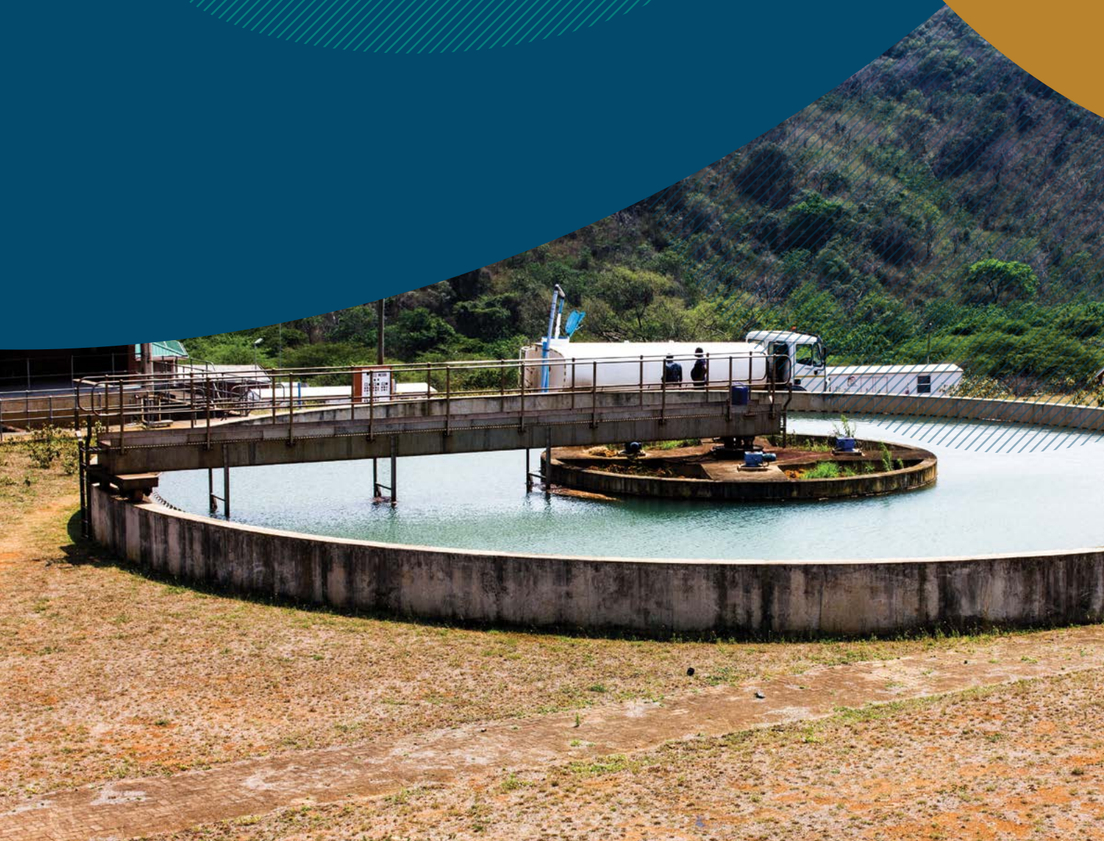
Clarifier at Thukela Goedertrouw Dam
